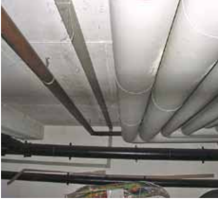
Bild 4: Fehlstrom von mehreren Ampere auf dem Trinkwasserrohr, zentral unter dem Wohnzimmer.
