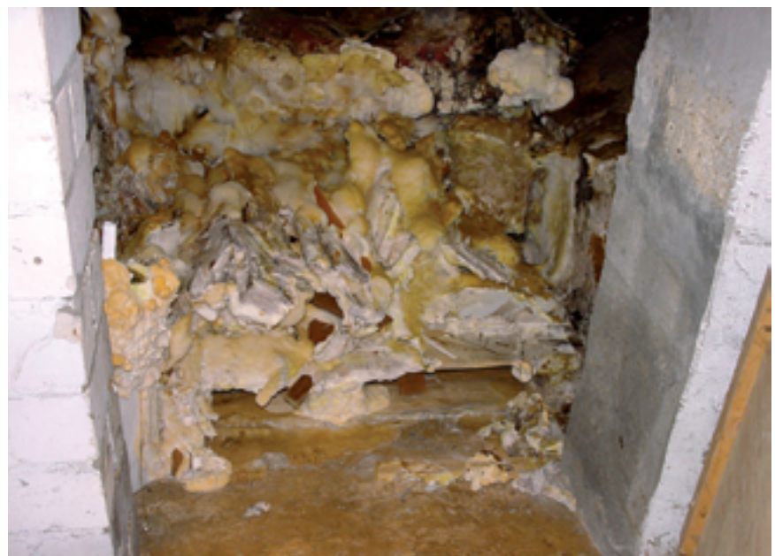
Ein farbenfroheres Erscheinungsbild, das ebenfalls zunächst unbemerkt blieb: Echter Hausschwamm im Keller eines Einfamilienhauses
