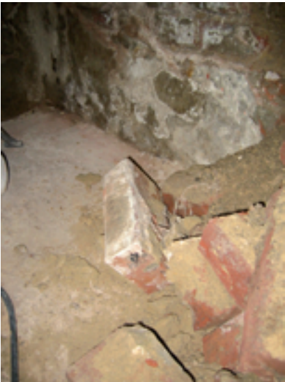
Das Strangmyzel wuchs bis in die Mauer hinein (hier auf vorsichtig herausgeschlagenen Ziegeln der inneren Steinschicht zu sehen)
